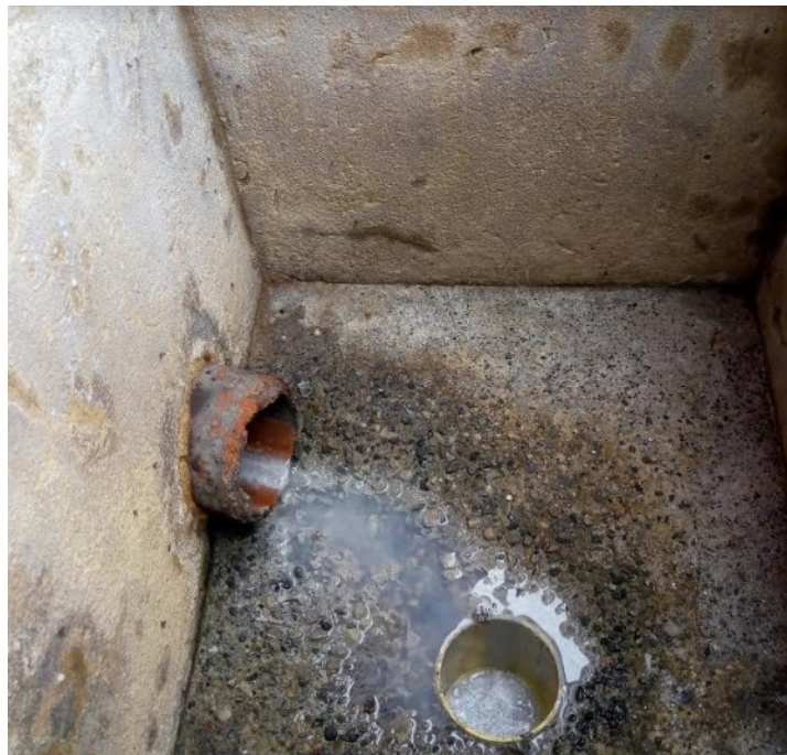
Figura 14. Identificación de caja de inspección y del vertimiento, proveniente de la empresa por producción de lácteos. Fuente: Autor.
