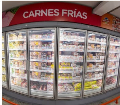
Figura 14: Sistema de Refrigeración Fuente: Autor
