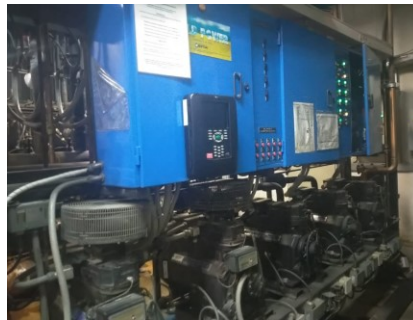
Figura 13: Planta de refrigeración
