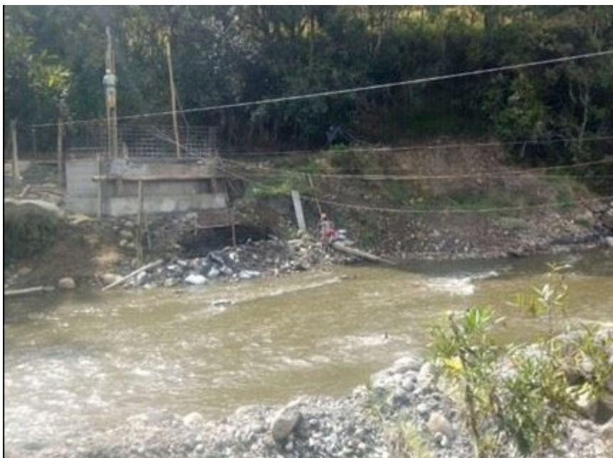
Figura 17 Alcaldía Municipal de Gacheta, (2018). puente vehicular en vereda Cusaquin, Recuperado de http://www.gacheta-cundinamarca.gov.co/ejecucion-20162019/2017010-construccion-de-puente-en-concreto-vereda-cusaquin
