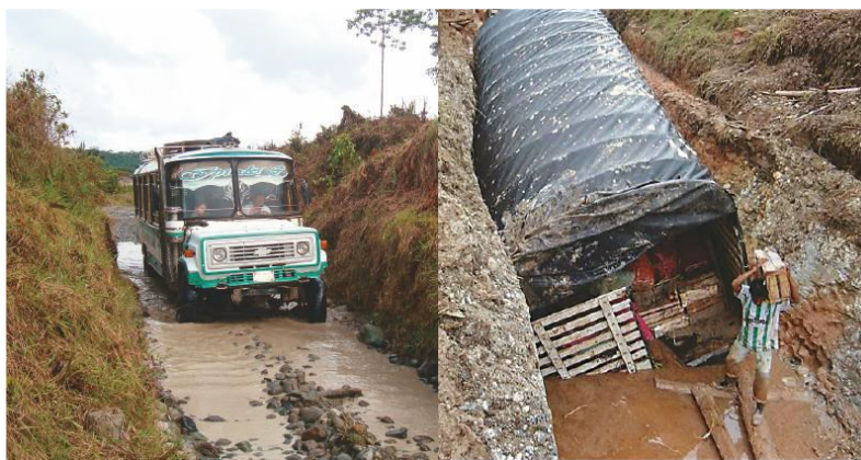
Figura 26 Revista Semana. (2015). Fotografía de vía Junín - Barbacoas destapada y en malas condiciones del departamento de Nariño.
