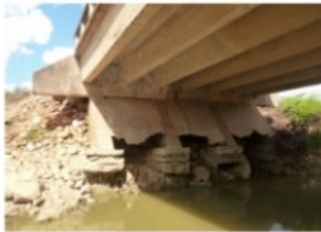
Figura 18 Juan Eloy P. (2014). Deformación talud ene estribo de puente, Fotografía tomada de Trabajo de diplomado Título: Propuesta de reparación en estribos y aproches
