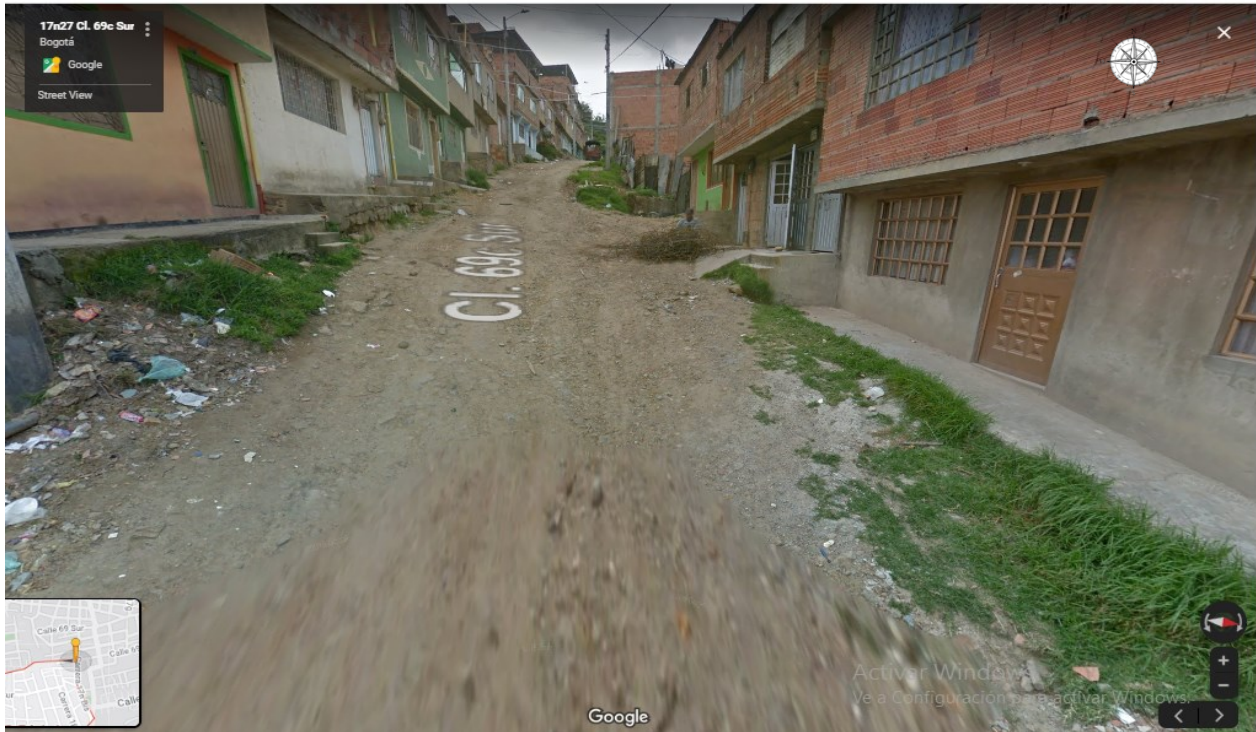
Figura 41 Estado de Algunas Vías del Barrio La Estrella Tomado de Google Maps (2020)
