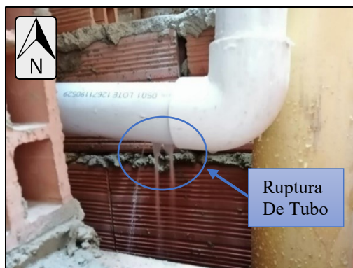
Figura 53. Ruptura de un Tramo de Tubo Durante Pruebas Hidrostáticas
