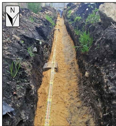
Figura 63. Señalización de Tubería
