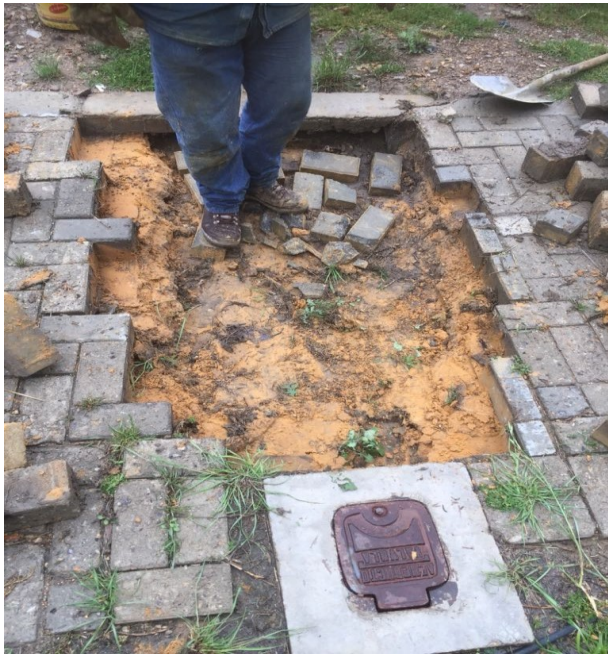
Fotografía propia- Desprendimiento y desnivel de adoquinado- Planta Pegatex [Figura 24].
