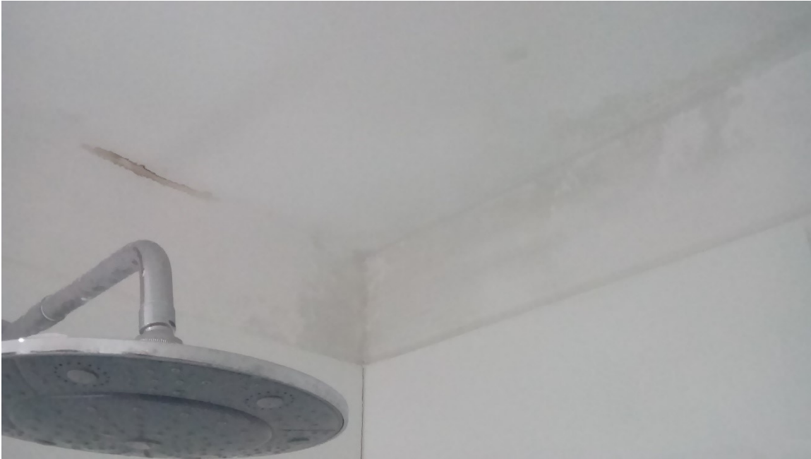
Fotografía propia- Humedad por condensación en ducha- Edificio Link [Figura 15].
