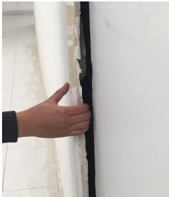
Fotografía propia- Desprendimiento Paño de enchape- Colegio San Bartolomé [Figura 20].
