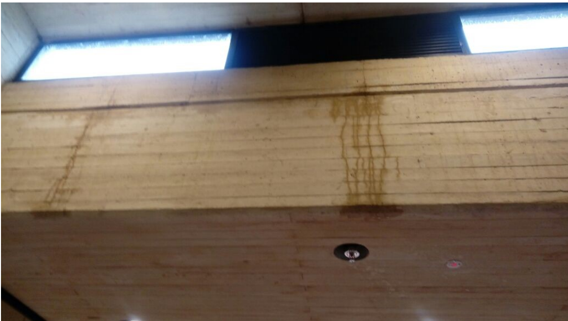
Fotografía propia- Filtración por Flanche- Faculta Enfermería Universidad Nacional [Figura 16].
