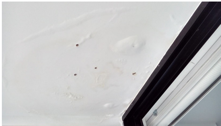
Fotografía propia- Humedad en cielo raso- Edificio Link [Figura 14].
