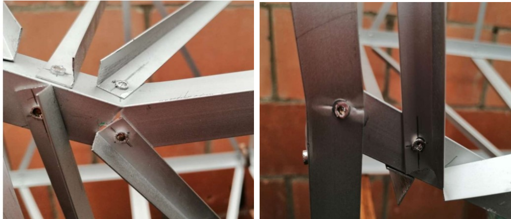
Ilustración 6 falla en conexiones Fuente Elaboración propia
