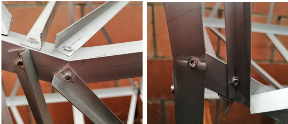
Ilustración 27 falla en conexiones
