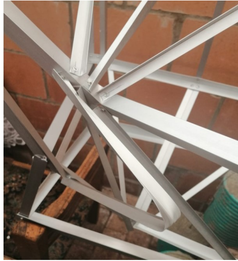
Ilustración 28 falla por flexo compresión
