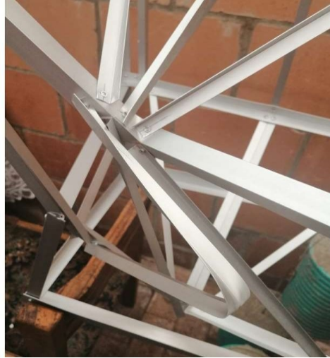
Ilustración 7 falla por flexo compresión Fuente
