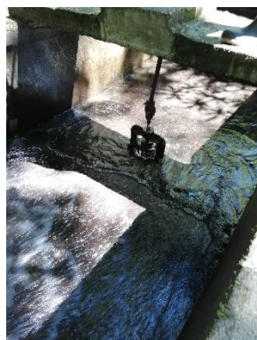
Evidencia fotográfica 25, Válvula de lavado del desarenador La Florida - 17 enero 2020.
