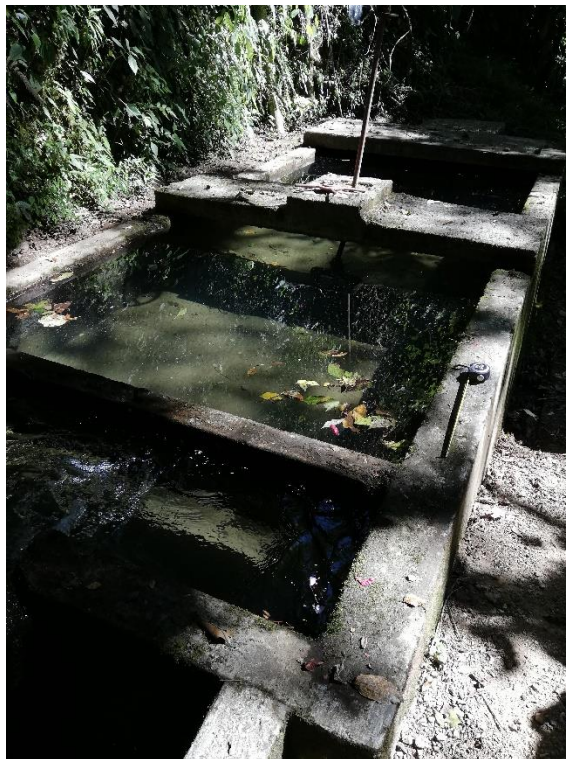
Imagen 7 Desarenador La Florida, fuente: tesista
