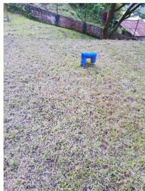
Evidencia fotográfica 33, Respiradero tanque de almacenamiento de la cabecera municipal - 23 febrero 2020.
