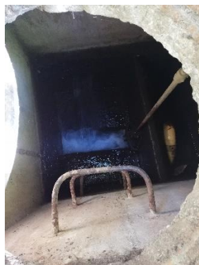
Evidencia fotográfica 15, Caja de derivación bocatoma Volconda -28 febrero 2020.
