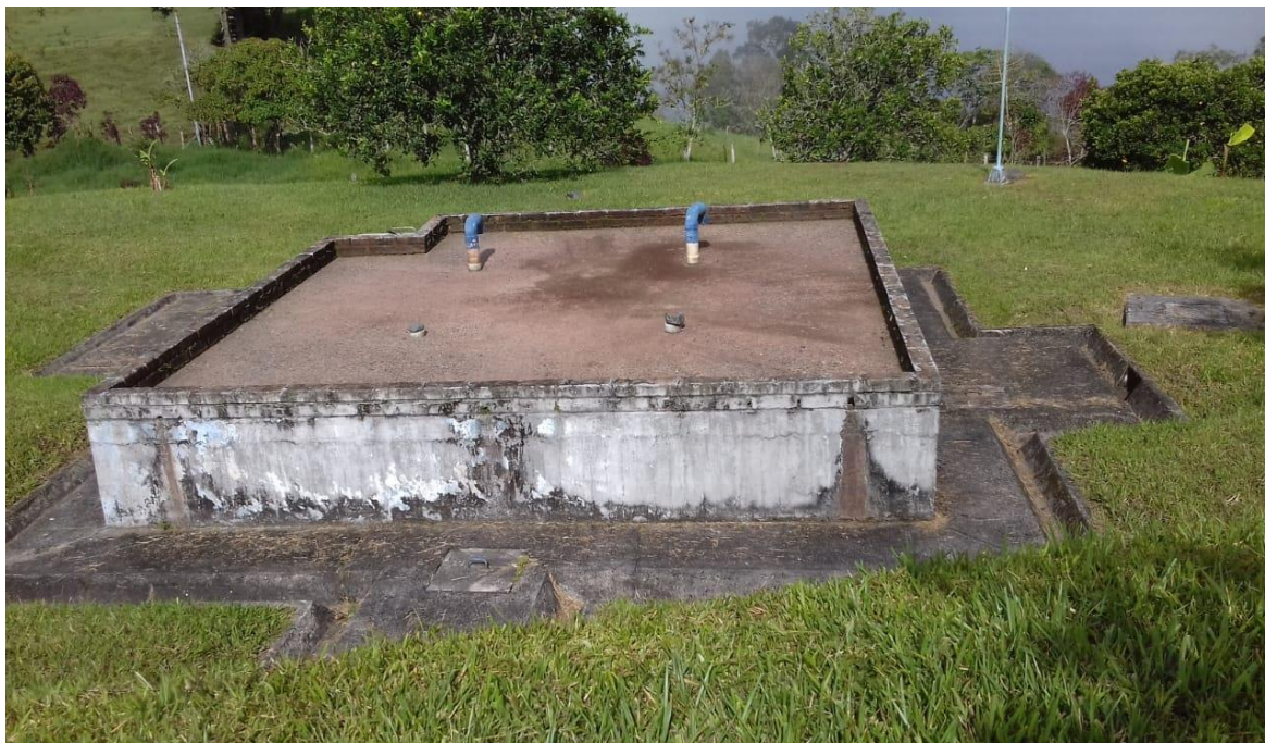
Imagen 9 Tanque Barrio Asprodica
