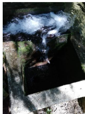
Evidencia fotográfica 20, Rebose desarenador La Florida - 17 enero 2020.
