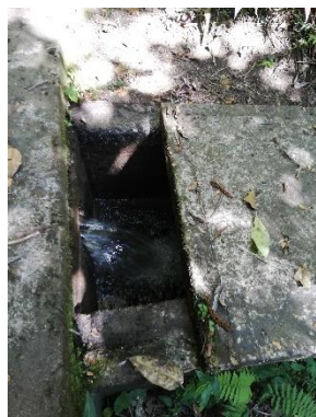
Evidencia fotográfica 19, Caja de salida desarenador La Florida - 17 enero 2020.
