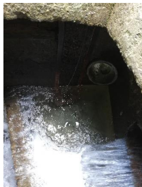
Evidencia fotográfica 29, interior de la caja de derivación bocatoma La Florida - 17 enero 2020.
