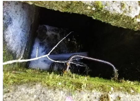
Evidencia fotográfica 10, Cámara de Lavado desarenador general - 117 enero 2020.
