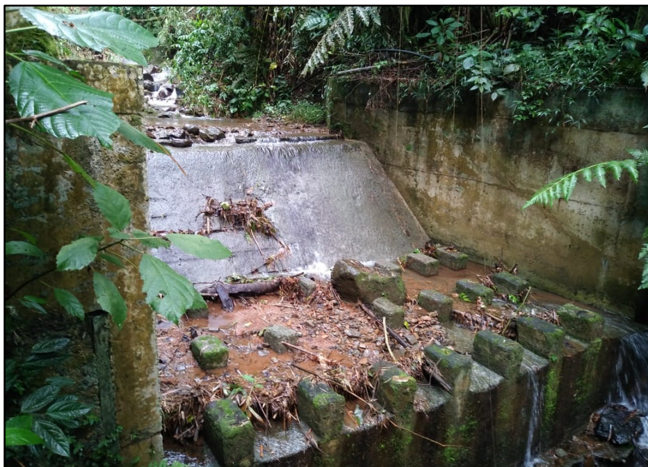
Imagen 3. Bocatoma Sistema Pavas
