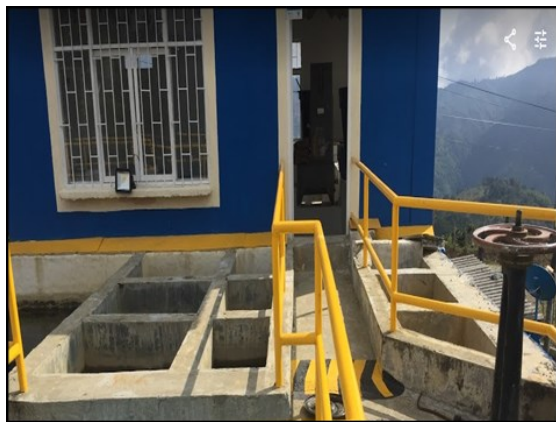
Figura 20. Floculadores de flujo vertical de codos tipo Alabama:
