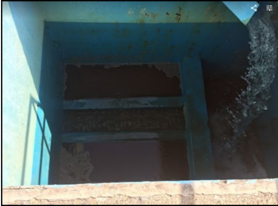
Figura 23. Sistema de Filtros
