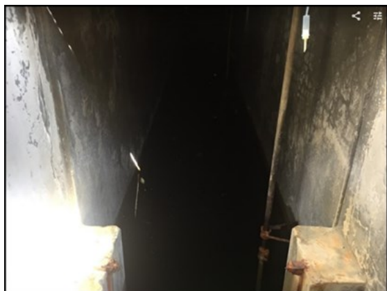
Figura 25. Canal común recolección agua filtrada y dosificación de cloro
