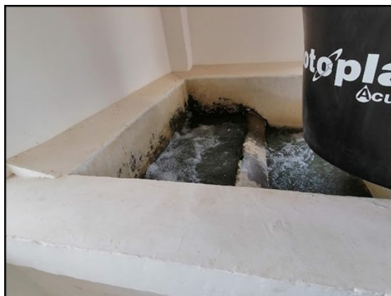
Figura 18. Tanque de quietamiento
