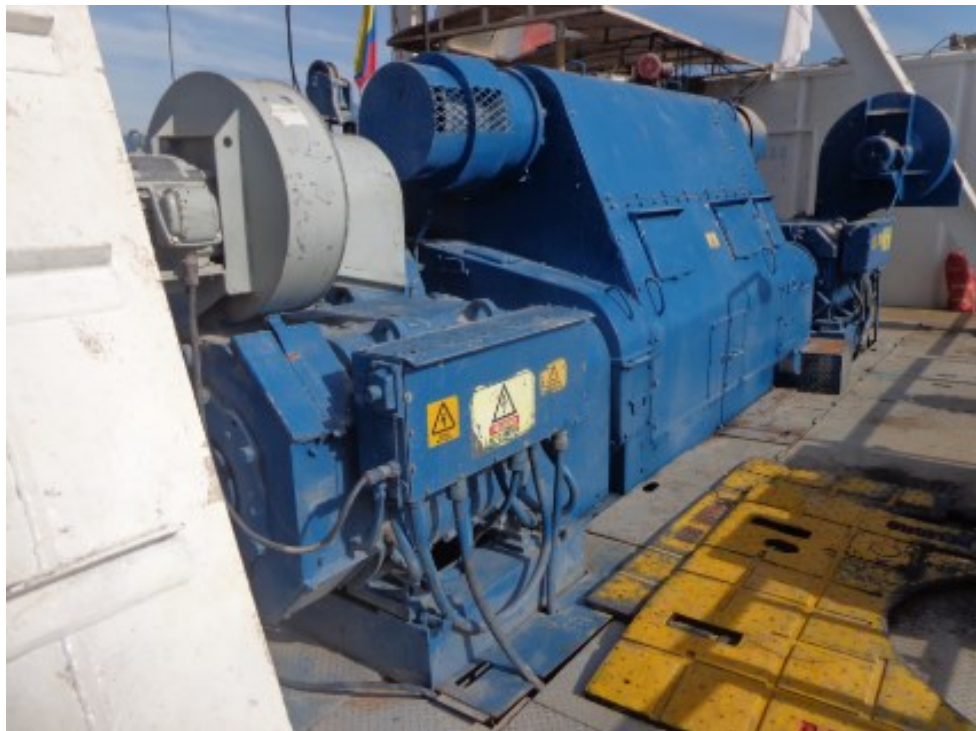
Figura 4.2-7: Malacate equipo de perforación
