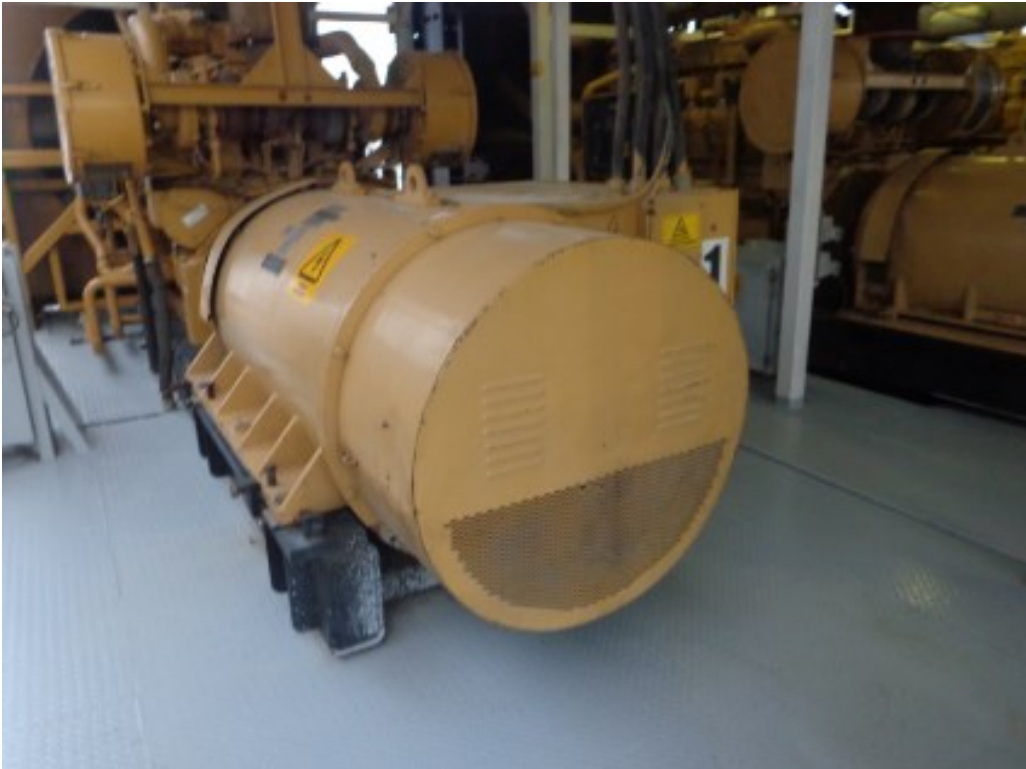
Figura 4.2-6: Grupo electrógeno equipo de perforación
