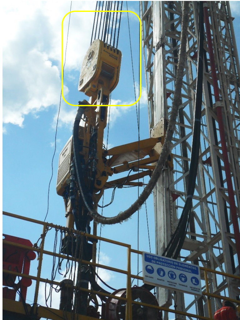
Figura 4.2-8: Bloque viajero equipo de perforación
