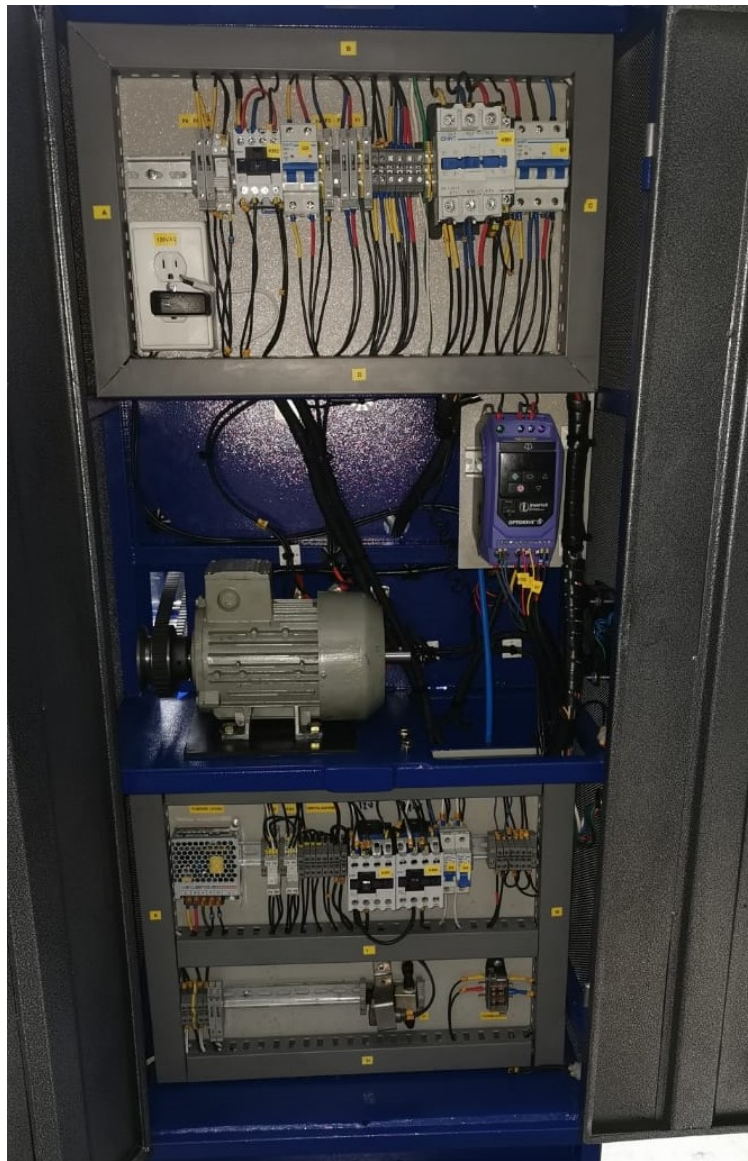
Figura 4-8: Ensamble final de componentes eléctricos.
