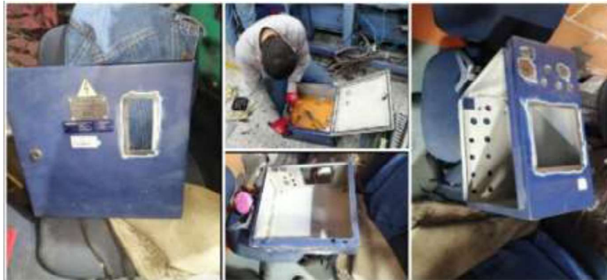
Figura 26 Tablero secundario. Fuente propia
