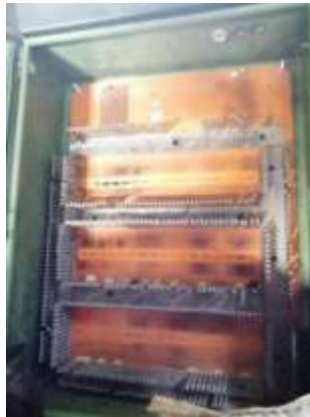
Figura 23 Fondo de tablero viejo. Fuente propia
