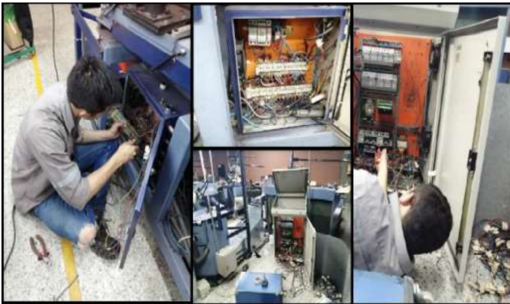
Figura 25 Marcación de tableros principal y secundario. Fuente propia
