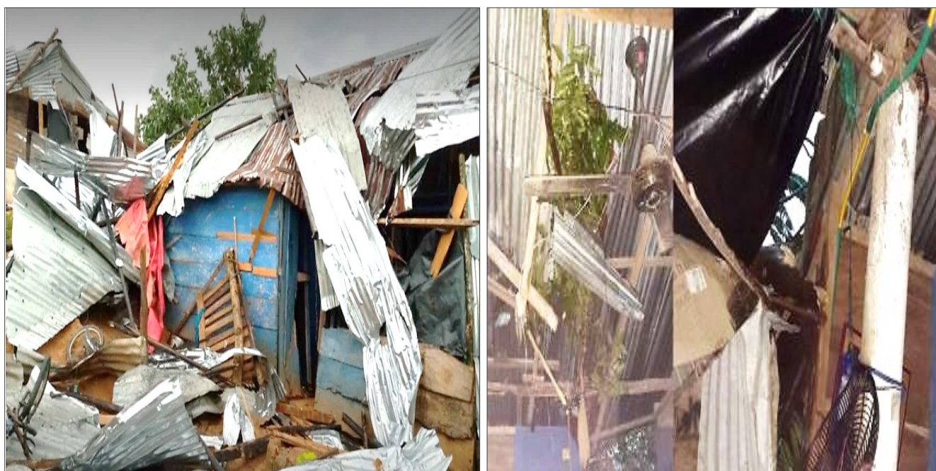
Figura 37. Daños en la infraestructura a causa de los fenómenos meteorológicos. Fuente: (El Heraldo, 2020)
