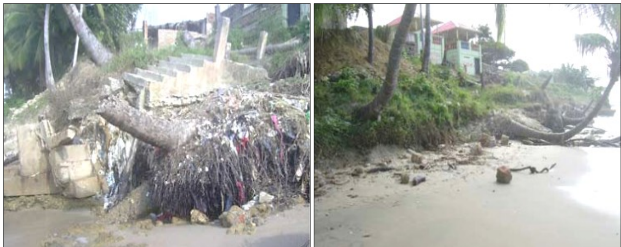
Figura 38. Se observa parte de la infraestructura urbana muy cerca del talud y afectada por la acción del mar. Fuente: (Invemar, 2008)
