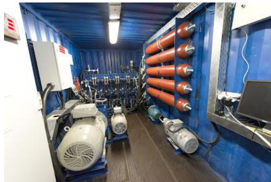
Figura 2-9: Sala de acumuladores y motores eléctricos
