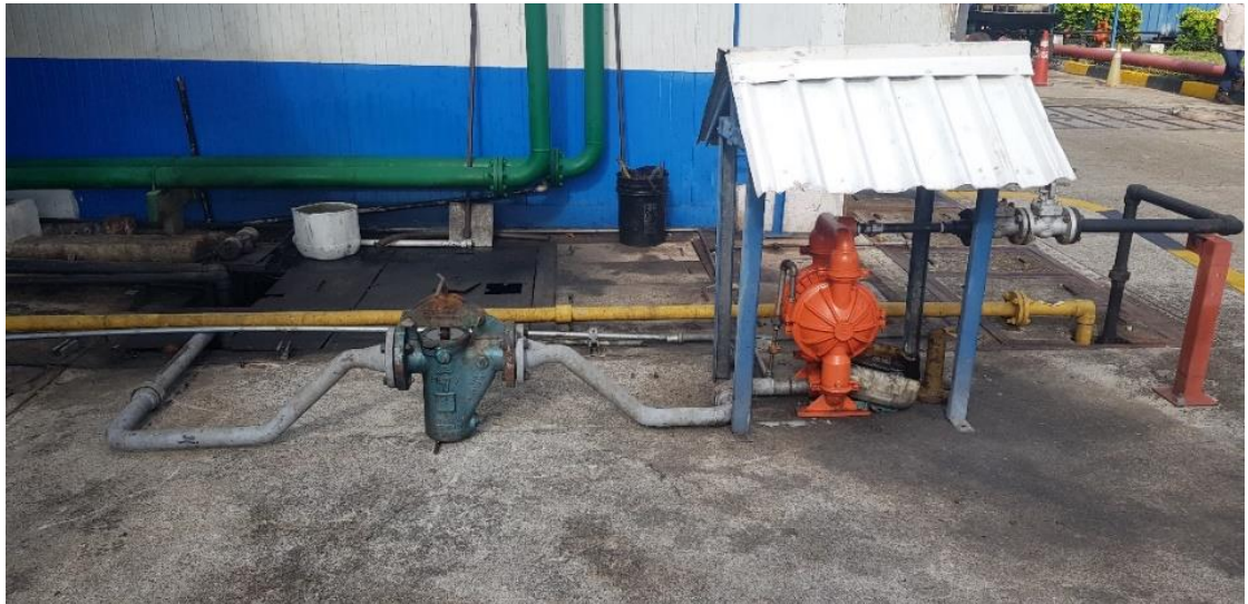
Figura 6. Sistema de bombeo
