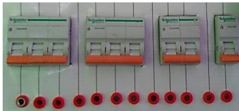
Figura 2-14: Breakers trifásicos, bifásicos y monofásicos.
