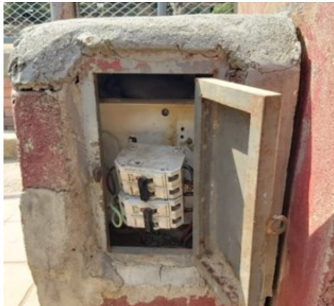
Fotografía 3. Control del sistema de alumbrado cancha de fútbol
