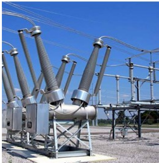
Figura 7. Interruptor de tanque vivo en patio
