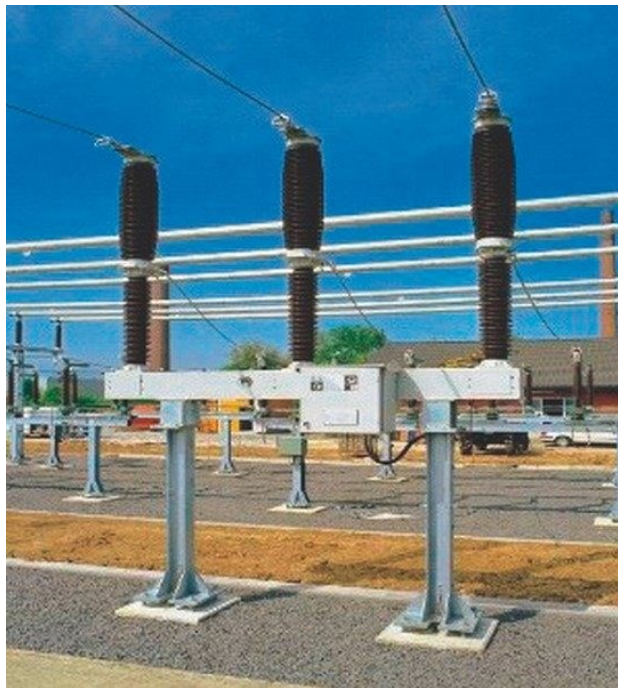
Figura 2. Interruptores de potencia
