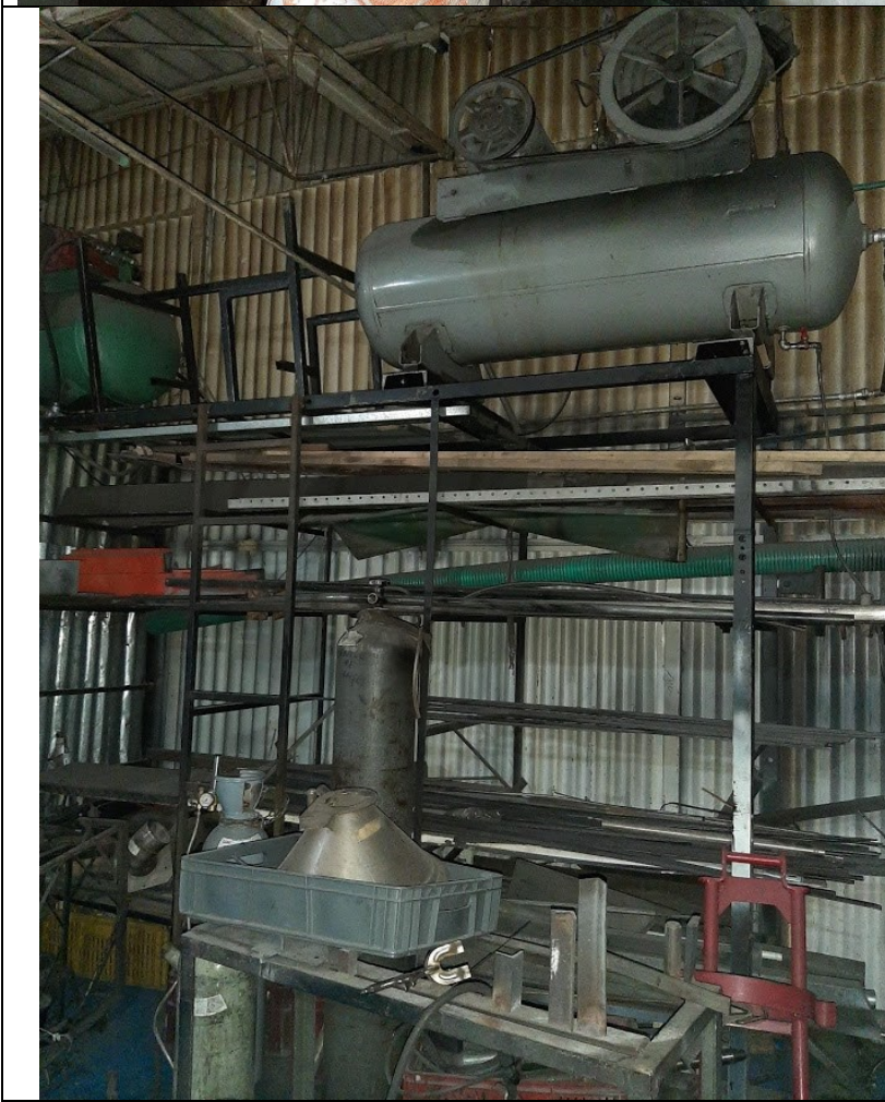
Segundo piso, Compresor, área de producción
