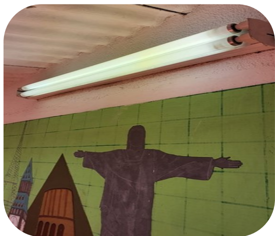
Luminarias externas de los baños de las mujeres
