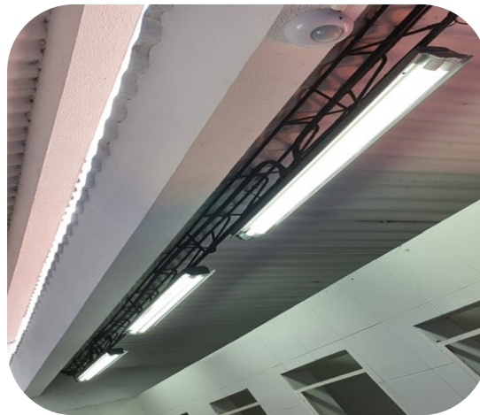
Luminarias instaladas en el baño de las mujeres
