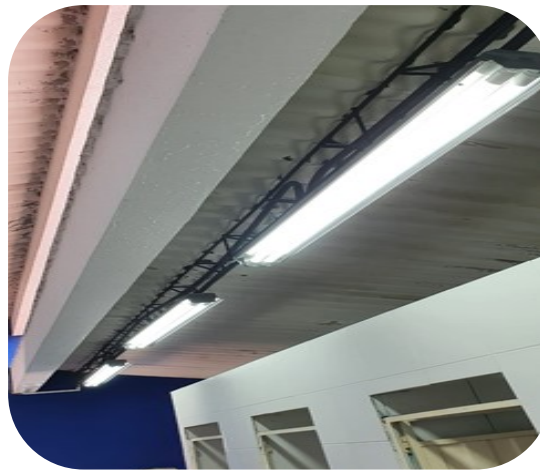
Luminarias instaladas en el baño de los hombres
