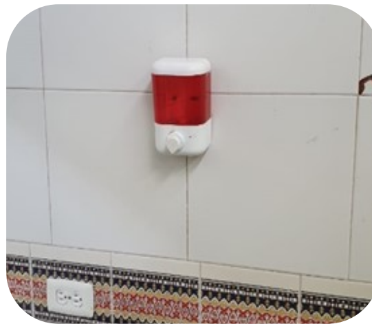
Relleno de jabon liquido dispensador baño de los hombres
