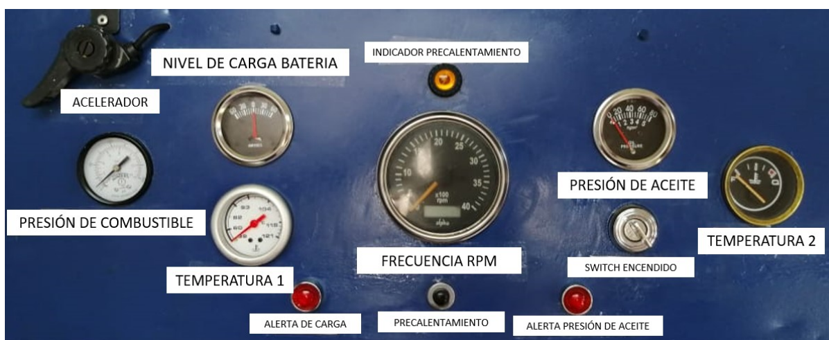
Figura 15. Tablero de control.
