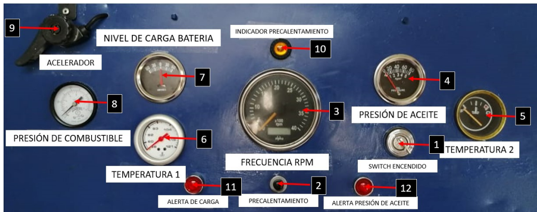
Figura 3: Identificación componentes del tablero de control.
