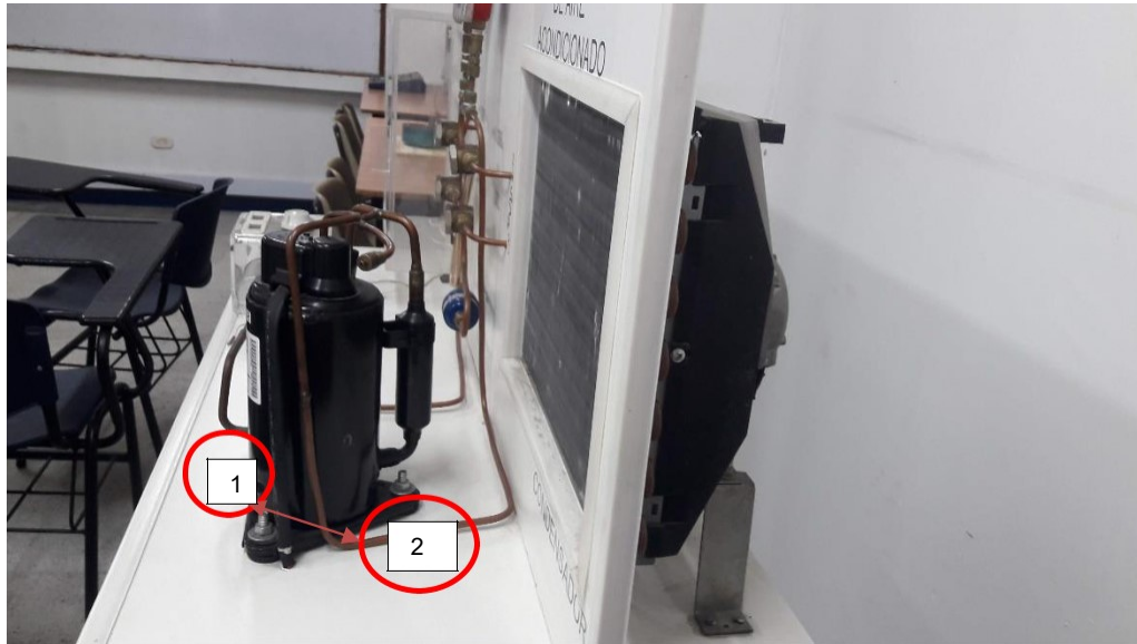
Figura.2-3: Identificación de fases en el módulo de aire acondicionado-B
