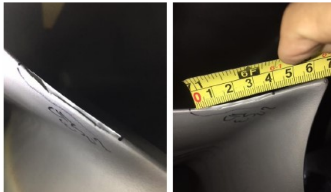
Figura 47. Falta recubrimiento cangilon 11.
