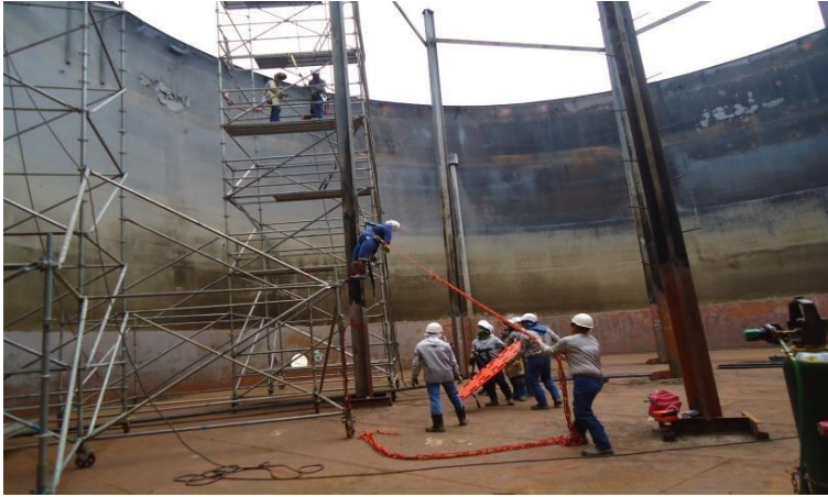
Figura 13. Maniobra de rescate del operario 8 minutos 22 segundos
