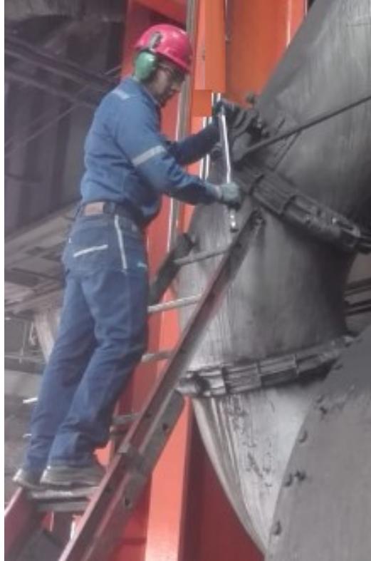
Figura 2-2: Prueba con torquímetro sobre la válvula de flujo de carbón
