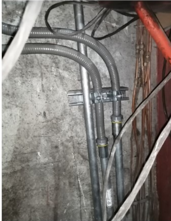
Figura 2-7: Instalación con tubería y flexiconduit
