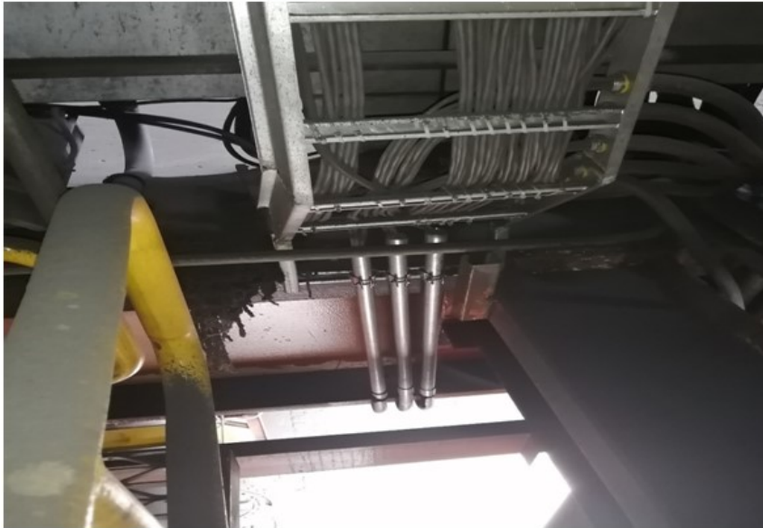
Figura 2-10: Salida de los módulos de ABB hacia el actuador
