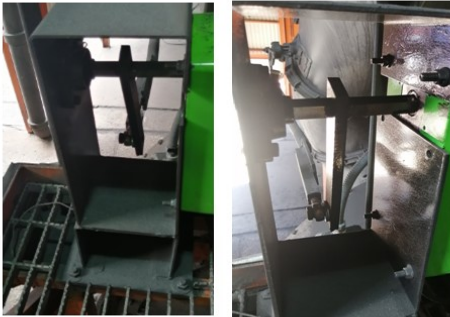
Figura 2-15: Adecuación mecánica para el posicionador y actuador
