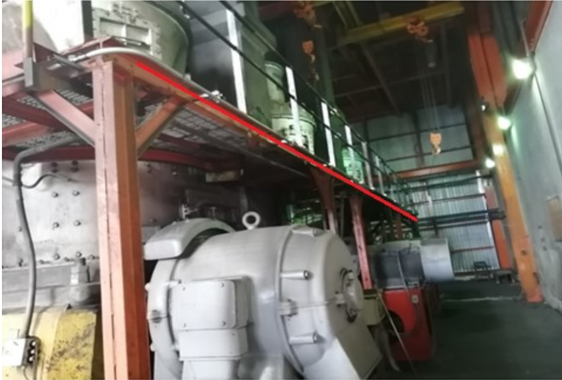
Figura 2-12: Acercamiento tubería de potencia en molino hacia actuador
