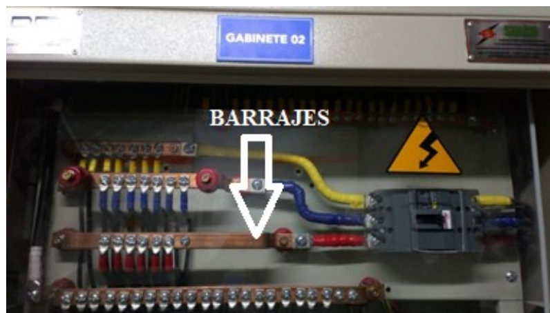
Imagen 6: Fotografía barraje gabinetes
