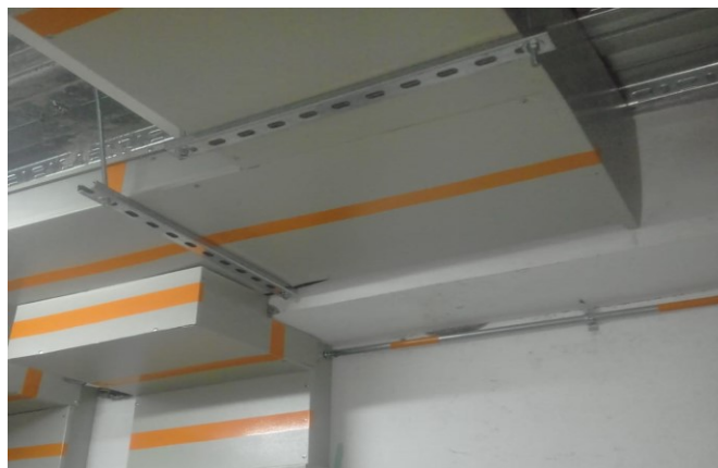
Imagen 8: Fotografía canaletas distribución
