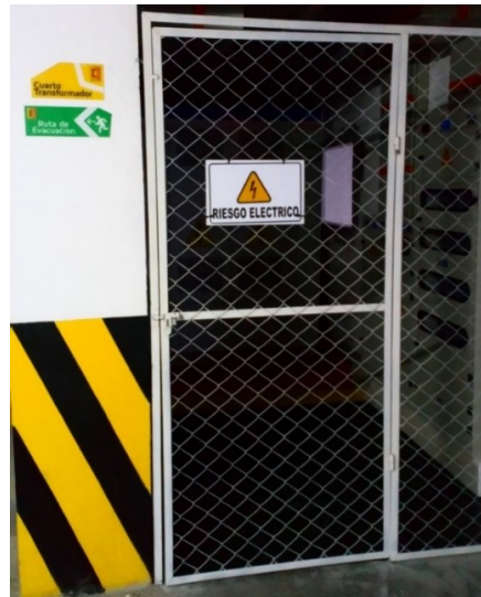
Imagen 9: Fotografía cuarto transformador
