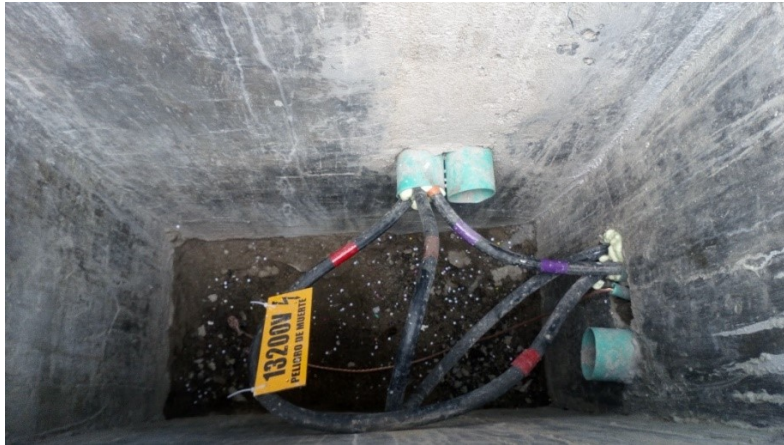
Imagen 4: Fotografía Acometida general
