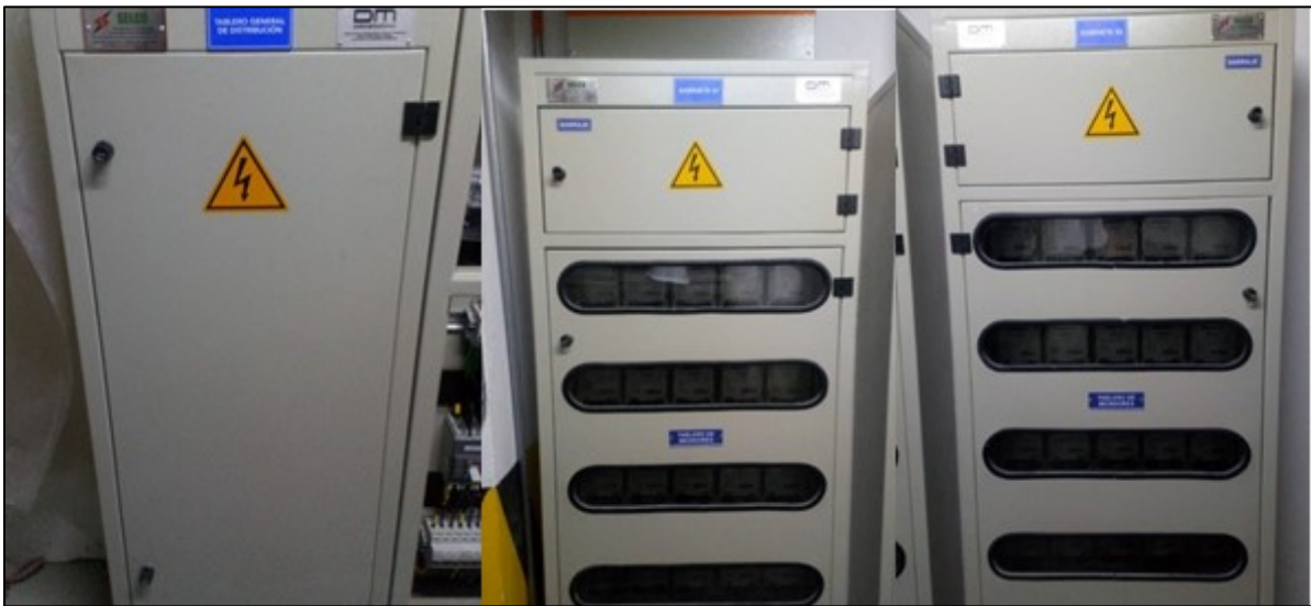
Imagen 5: Fotografía tablero de distribución.
