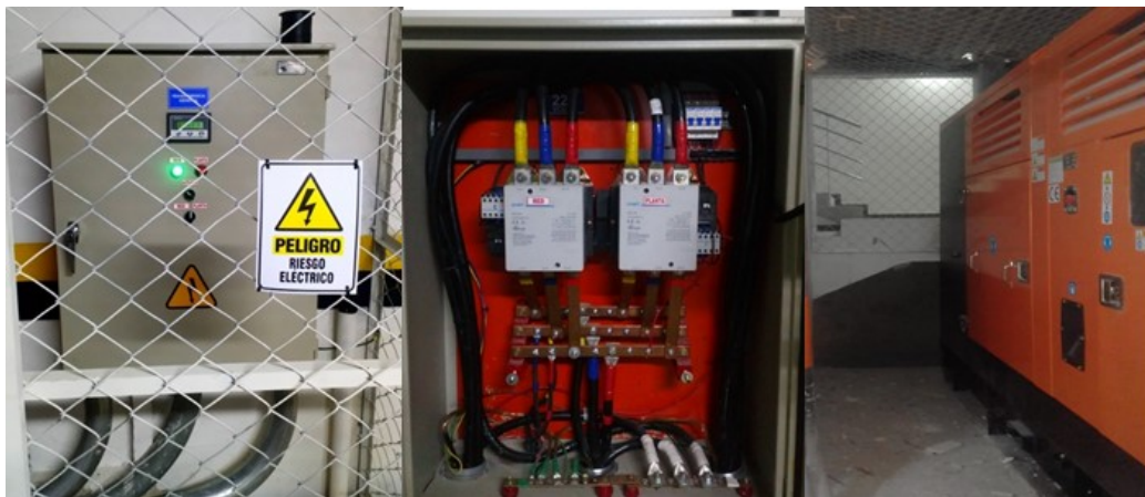
Imagen 10: Fotografía planta eléctrica
