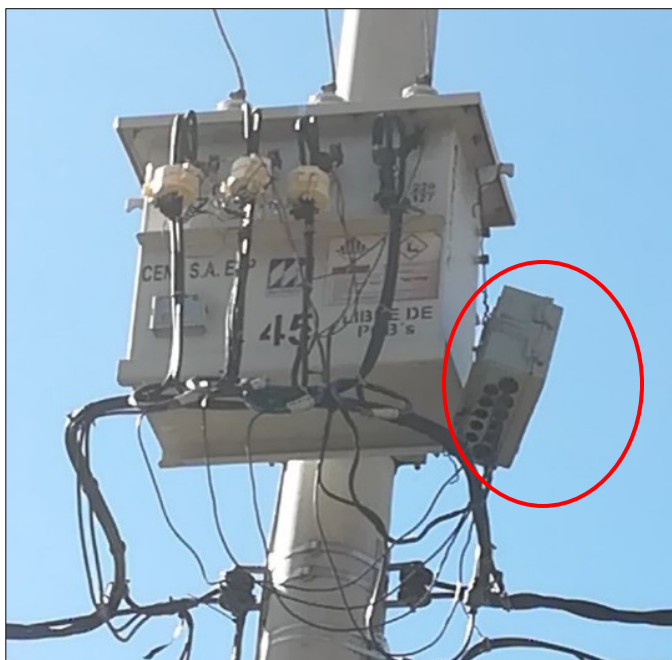
Ilustración 18. Analizador de red instalado en transformador. Autoría Propia.
