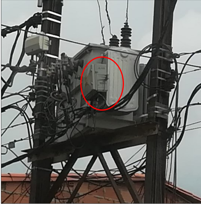
Ilustración 19. Analizador de red instalado en transformador- estructura en camareta. Autoría Propia.
