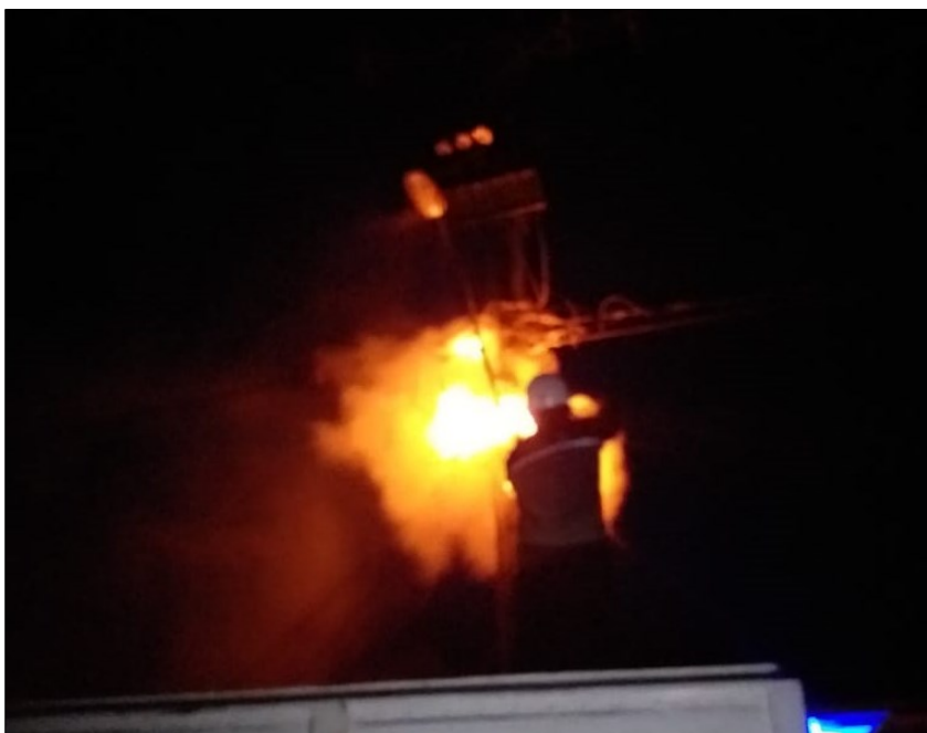
Ilustración 29. Incendio de transformador. Autoría Propia
