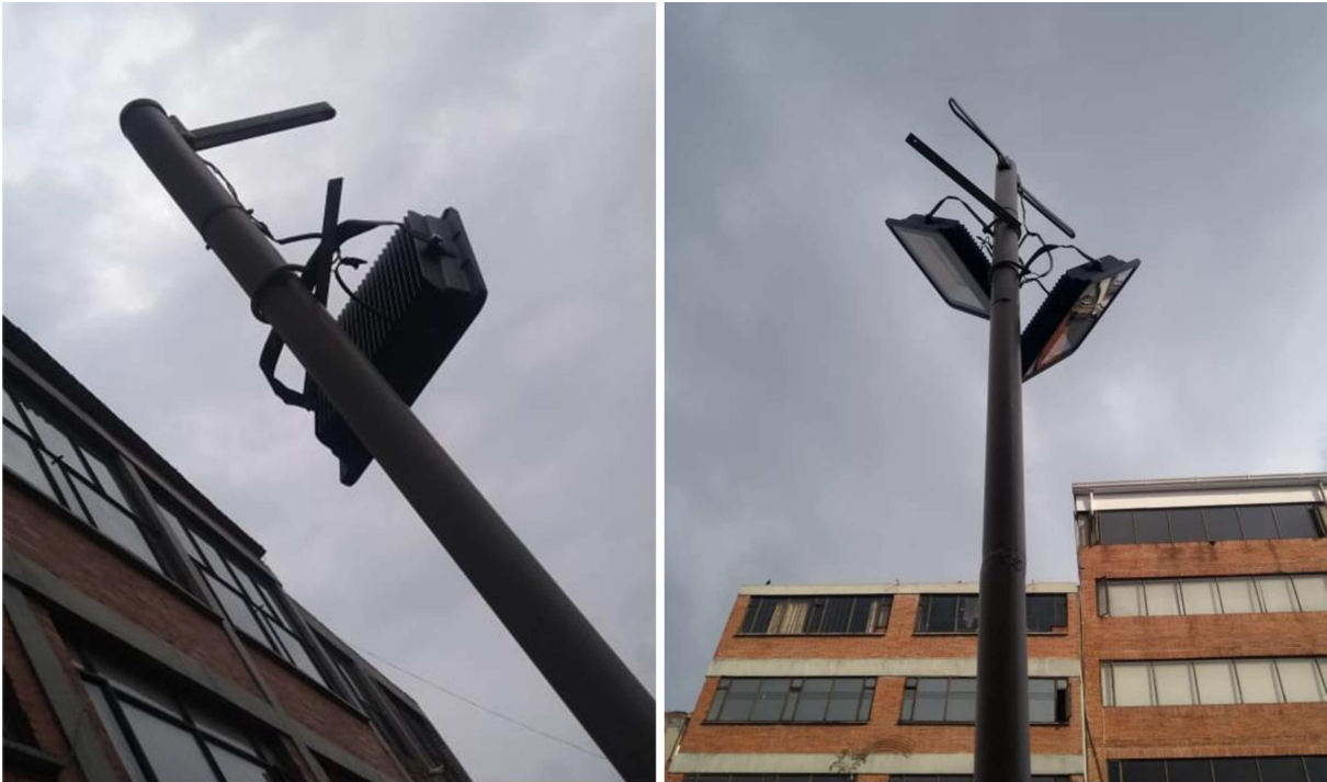
Figura 11. Evidencia de empalmes en cinta en la instalación de las nuevas lámparas LED
