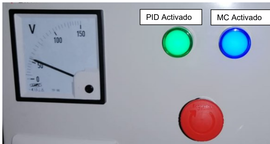
Figura 47 Indicación de MC y PID en el tablero de control.
