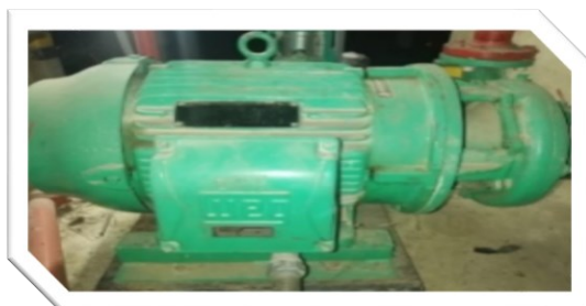
Fig. 8: Fotos de las bombas agua potable instaladas en la universidad.
