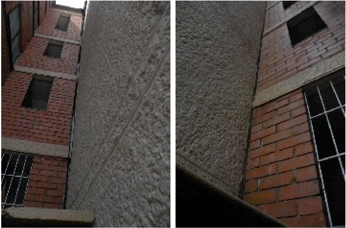
Registro Fotográfico 1 Dilataciones y desplomen entre bloques y puntos-fijos
