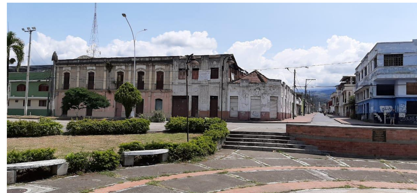
Deterioro del bien patrimonial arquitectónico.
