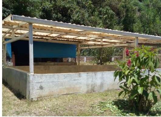
Ilustración 40: Lechos de Secado de Lodos PTAP Convencional Mistrató. Fuente: Elaboración propia.
