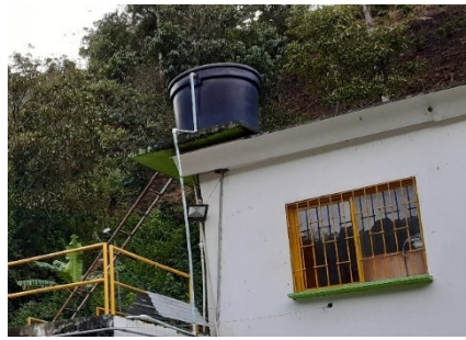
Ilustración 36: Tanque para mezcla de cloro PTAP convencional Mistrató. Fuente: Elaboración propia.
