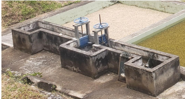
Ilustración 26: Vertederos Triangulares de Entrada a FGA. Fuente: Elaboración propia.
