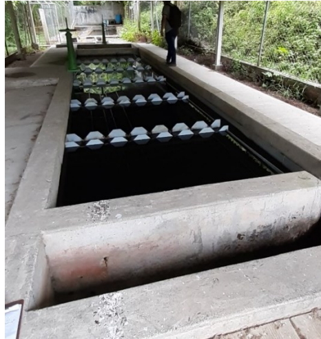
Ilustración 13: Sedimentador de Alta Tasa. Fuente: Elaboración Propia.
