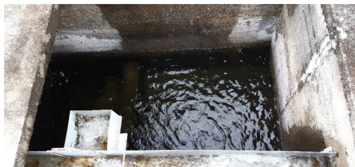
Ilustración 34: Canaleta de distribución de flujo a filtros – PTAP convencional Mistrató. Fuente: Elaboración propia.
