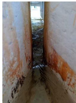
Ilustración 31: Represamiento de flujo en Canaleta Parshall. Fuente: Elaboración propia.
