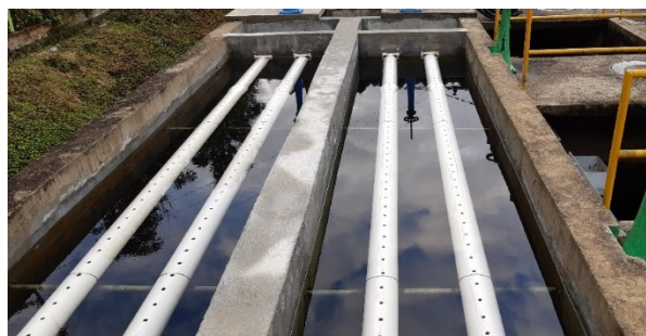
Ilustración 33: Sedimentadores de Alta Tasa – PTAP Mistrató Risaralda. Fuente: Elaboración propia.
