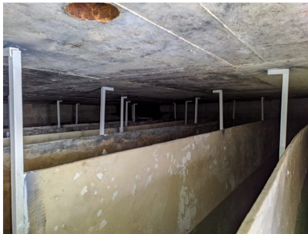
Ilustración 39: Interior del Tanque de Contacto de Cloro PTAP Mistrató. Fuente: Elaboración propia.
