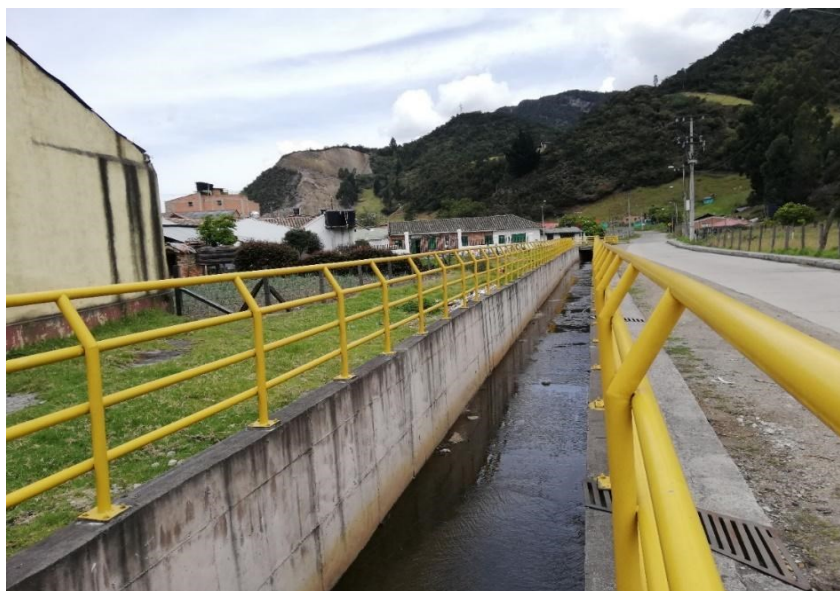
Figura 18. Canal con riesgo de inundación o desborde 2
