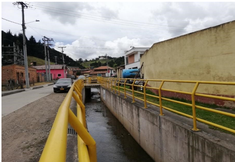
Figura 17. Canal con riesgo de inundación o desborde 1
