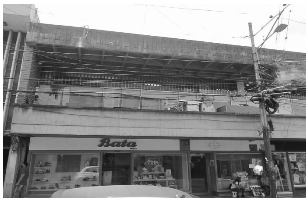
Ilustración 131. Banco Cafetero Deterioro Fuente: Propia
