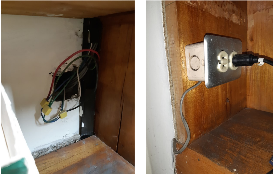
Figura 4-3: Riesgos eléctricos biblioteca.
