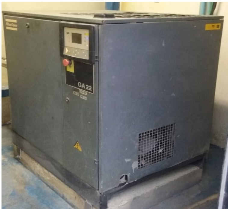
Figura 4. Compresor GA 22 Atlas Copco, Área de Producción Zootecnia Sólidos
