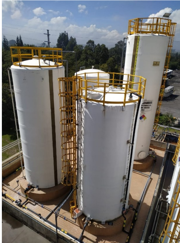
Figura 2-1 Tanques de Almacenamiento Brinsa S.A
