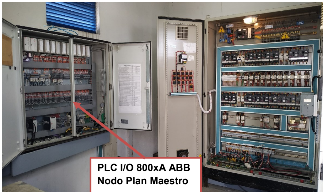
Figura 3-4 Cuarto eléctrico tablero conexiones PLC
