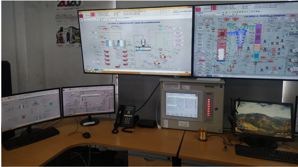
Figura 2-5 Sistema SCADA caldera No. 6 de la empresa Brinsa S.A
