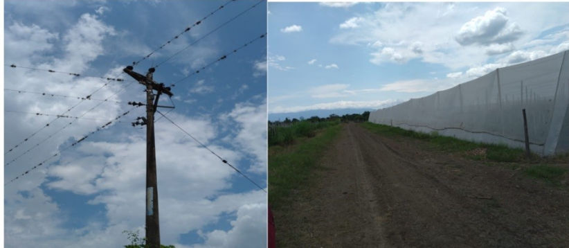
Figura 4-9: Red eléctrica de media tensión del último poste de distribución.
