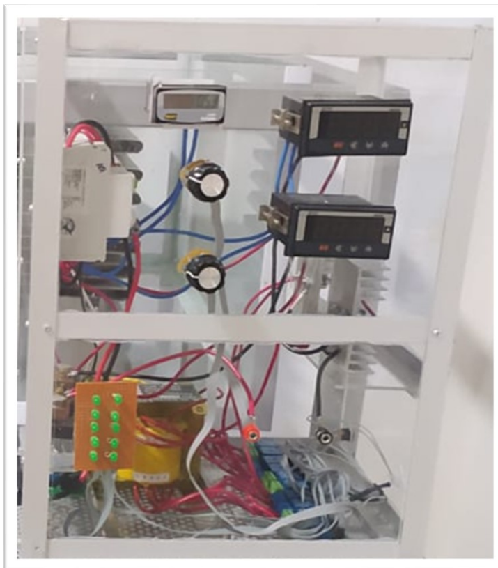
Ilustración 16. Unidad Rectificadora de Protección Cádica
