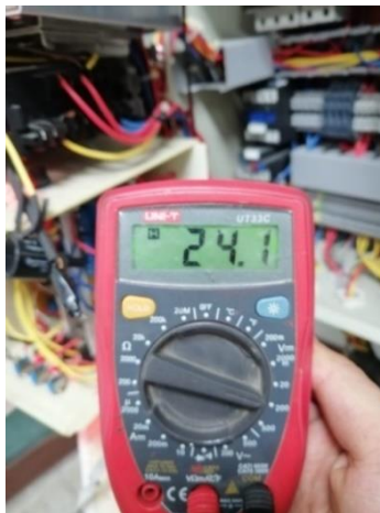
Figura 2-21: Medición del nivel de tensión en la fuente DC de 24v.
