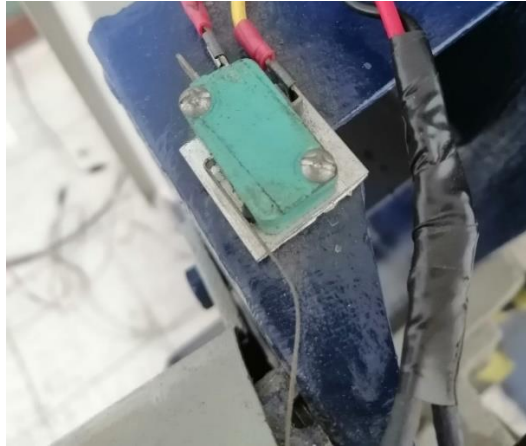
Figura 2-27: Sensor en las guardas de protección.
