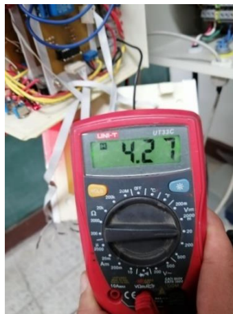
Figura 2-22: Medición del nivel de tensión en las borneras de 5v.
