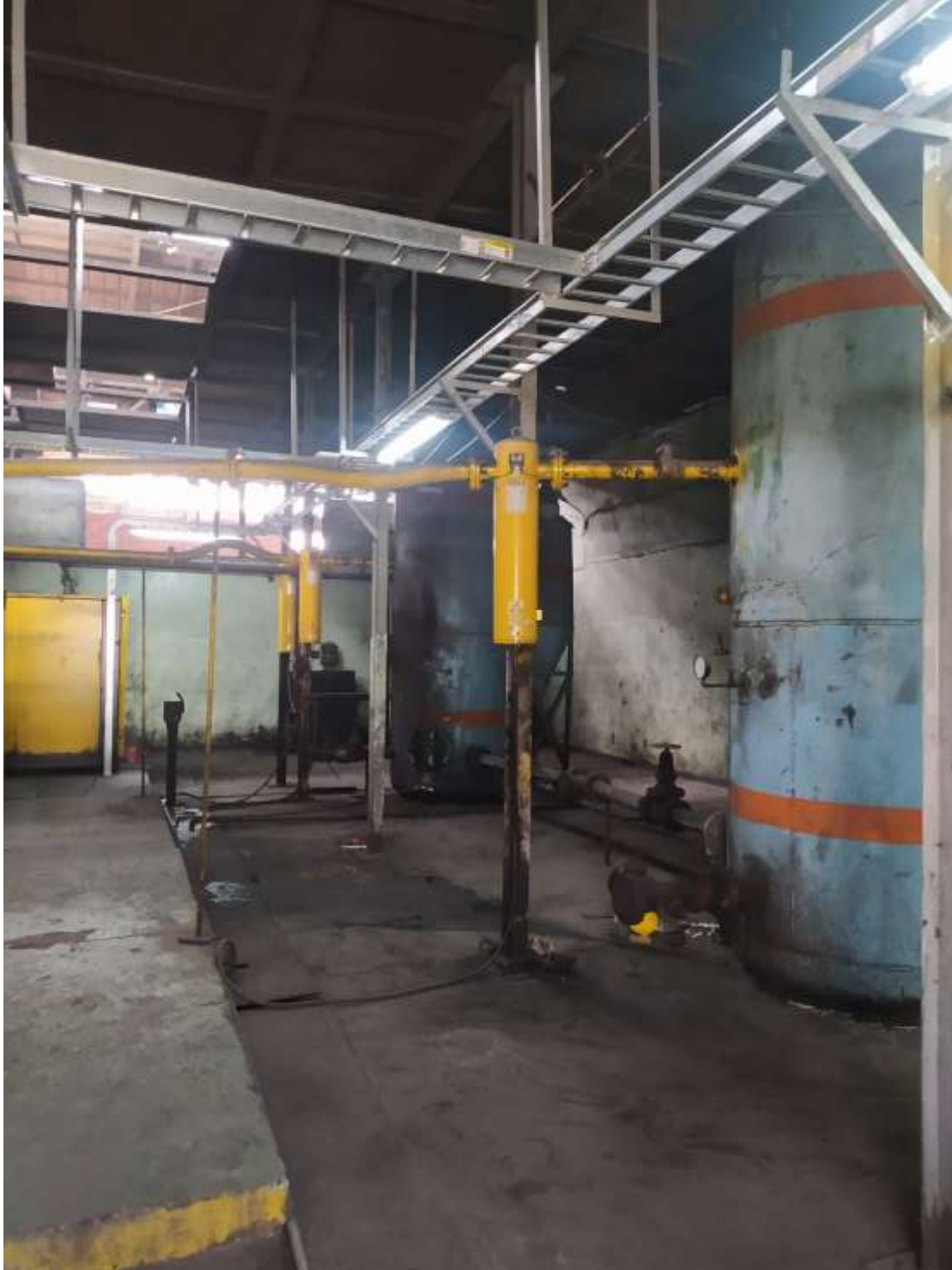
Figura 3: Depósitos de aire instalados actualmente de 4000 litros cada uno de ellos con filtros de línea a la salida de compresor.
