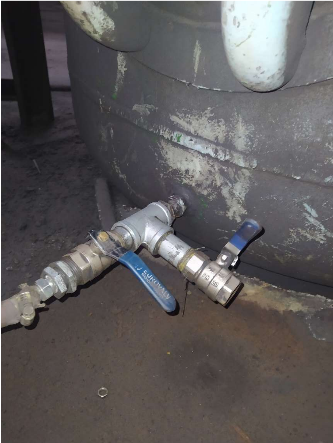
Figura 2: Válvulas de bola parcialmente abiertas para extracción de condensado depósito de aire.
