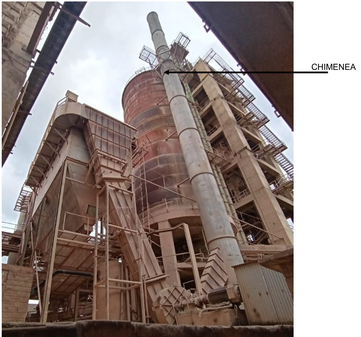
Figura 2-6. Chimenea Filtro de Mangas, Molienda de Crudo.
