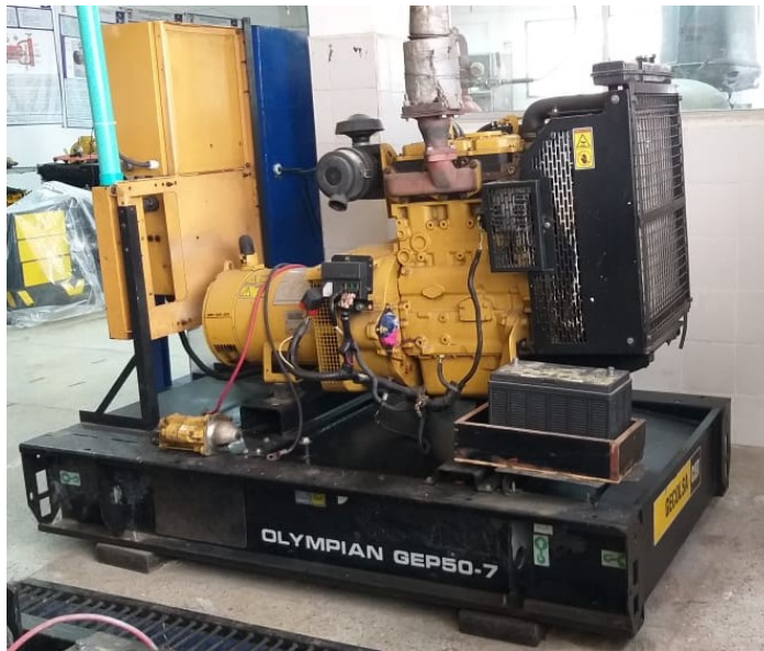
Figura 7.1 Motogenerador Olympian GEP 50-7.
