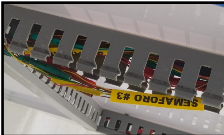
Ilustración 92: Revisión en los empalmes de pines con recubrimiento de termoencogible.
