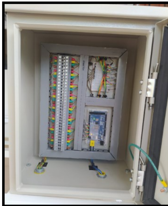
Ilustración 78: resultado finales de las instalaciones en el cofre/gabinete eléctrico (puesta en marcha).
