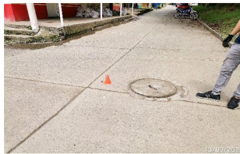
Figura 21. Estado de cañuela de pozo N°102.
