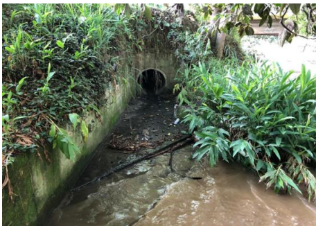
Figura 18. Estructura de salida de descole N° 3.
