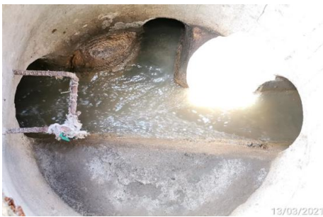
Figura 20. Estado de cañuela de pozo N°104.
