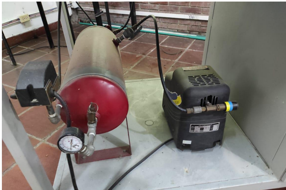
Figura 6-4: Compresor y depósito de almacenamiento.
