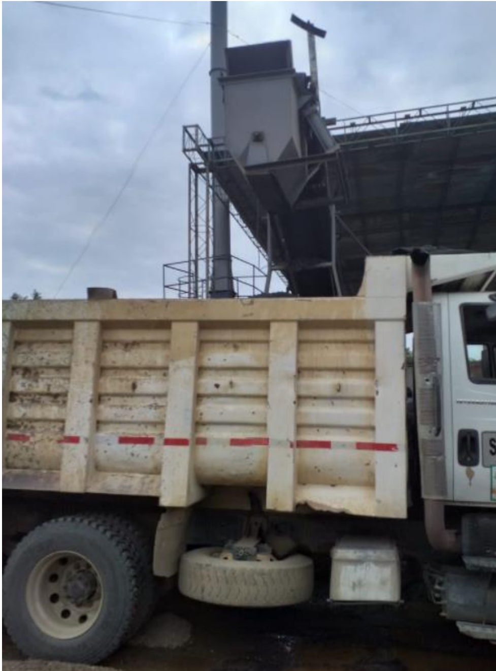
Figura 13 Silo de almacenamiento
