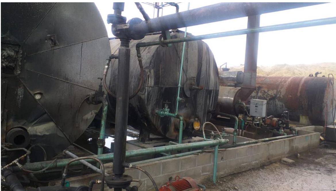
Figura 10 Tanques de almacenamiento
